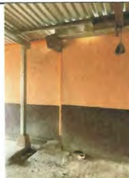
Foto 4: Se observa drenaje ineficiente de captacion.
