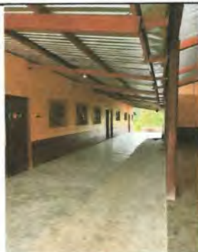
Foto 3: Daños en canal de captación pluvial, drenaje ineficiente, desbordamientos y goteras, acumulación de desechos, problemas de diseño
