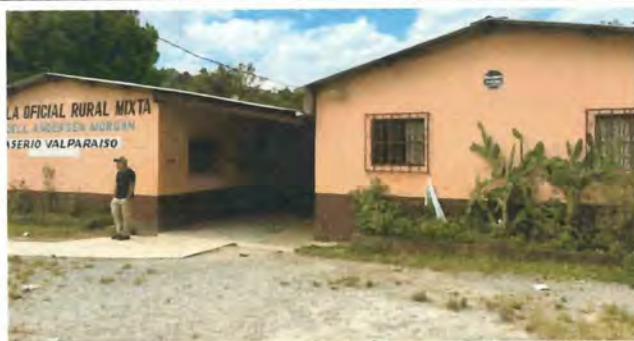
Foto 1: Se observa un espacio reducido a ingreso principal, es por ello que se quiere intervenir y mejorar la estructura metalica y las laminas
